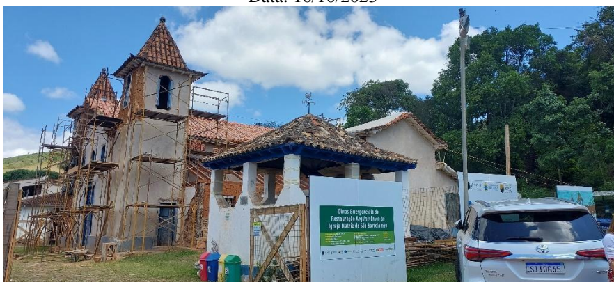
Vista lateral da Matriz de São Bartolomeu e placa da obra Autoria: Maria Letícia Ticle Data: 16/10/2023
